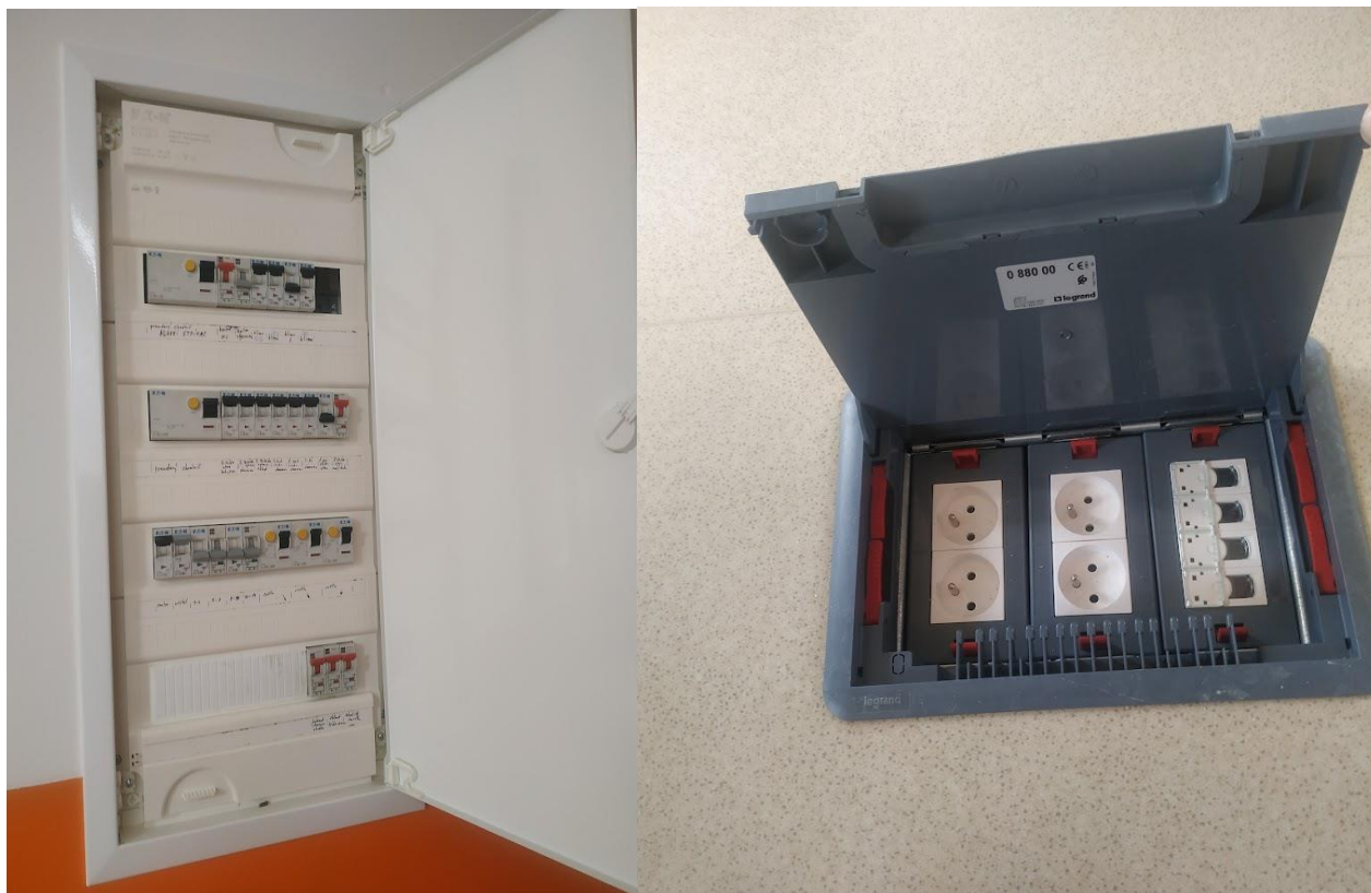
Nové elektrorozvody v podkroví; IT rozvody v učebně informatiky (zabudované do podlahy)
